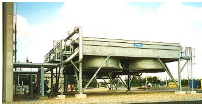
Erdgasspeicher Kalle - Verdichter 5
